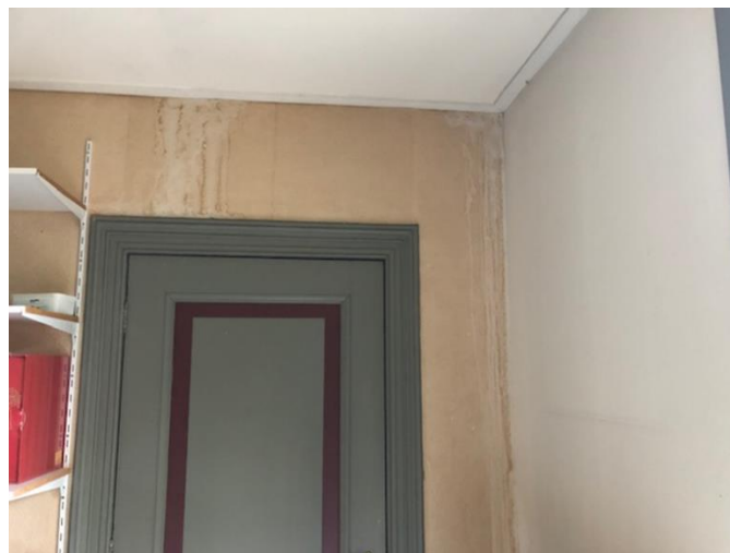
Enkele ruimten met waterschade.
